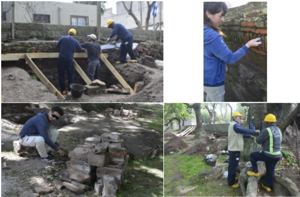
Figura 2: Arriba a la izquierda, desarme de sectores comprometidos del muro (carpeta 12/10/2018). Abajo a la izquierda, limpieza de ladrillos para ser colocados en el muro (carpeta 08/11/2018). Arriba a la derecha, limpieza del muro con cepillo de acero para introducir Sikatop Modul (carpeta 08/11/2018). Abajo a la derecha, preparación de pilar con varillas de 8 mm tratadas, cada 20cm un estribo de varilla de 8mm de 20 cm de longitud dentro del muro (carpeta 12/10/2018).
