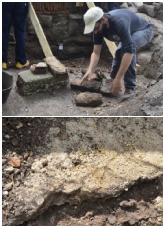
Figura 4: Arriba, ladrillos extraídos del muro I, sin cepillar y con argamasa (12/10/2018). Abajo, argamasa en sitios donde se extrajeron ladrillos del muro I (carpeta 12/10/2018).
