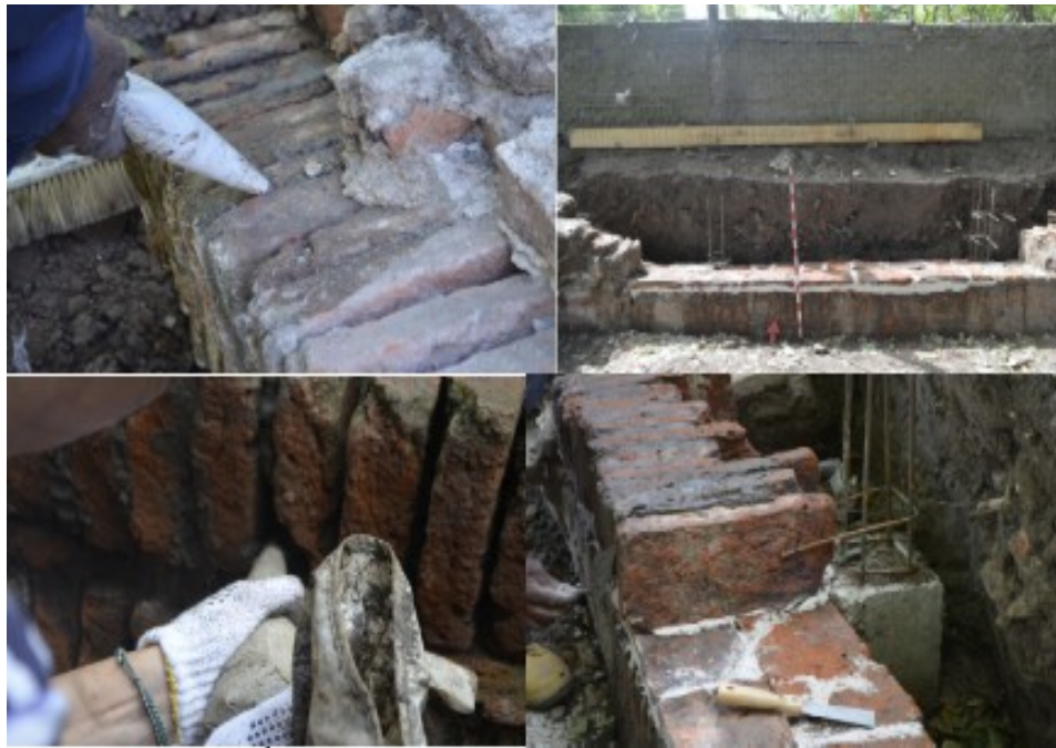
Figura 15: Arriba a la izquierda introducción de argamasa con manga repostera (carpeta 08/11/2018). Abajo a la izquierda introducción de argamasa con manga repostera (13/11/2018). Arriba a la derecha muro con ladrillos horizontales colocados y cimentados (08/11/2018). Abajo a la derecha colocación de ladrillos verticales e introducción de estribos de los pilares para evitar el derrumbe (carpeta 08/11/2018).
